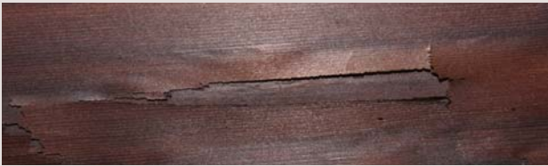
「次室」の杉張桁の天井板。表面の板が破れて、杉桁のスライスを張った板であることが分かる
