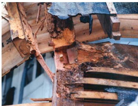
地震で損壊した住宅のシロアリ被害
