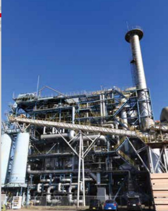
三菱商事と共同で運営する神の池バイオエネルギーは2万1000kWの出力能力があり、神栖市の電力需要を賚るほど。運良く近隣に飼料会社が7社あり、その穀物乾燥用の熱源として蒸気も販売している。
